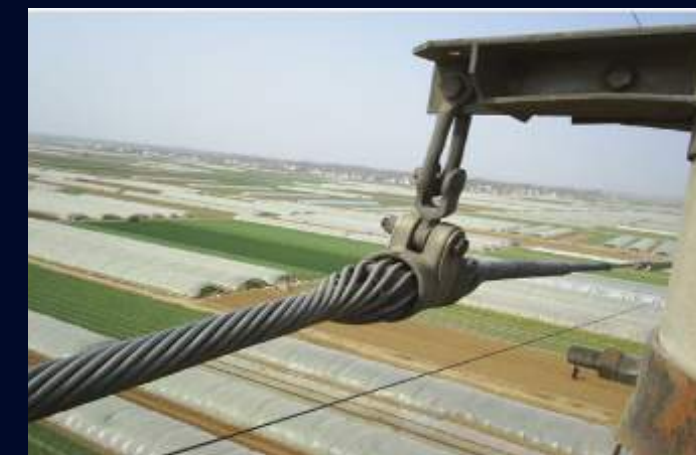
FIBRA ÓPTICA OPGW
